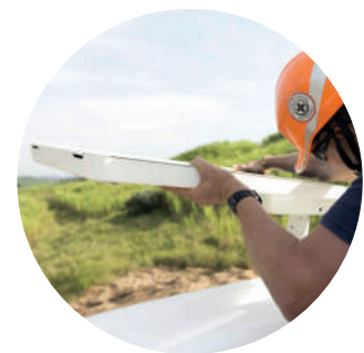
Installation et maintenance
